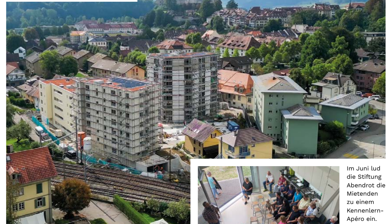
Die Baustelle zeigte mit zunehmender Höhe und wachsender Ausgestaltung das neue, vollständige Gesicht des Areals.
