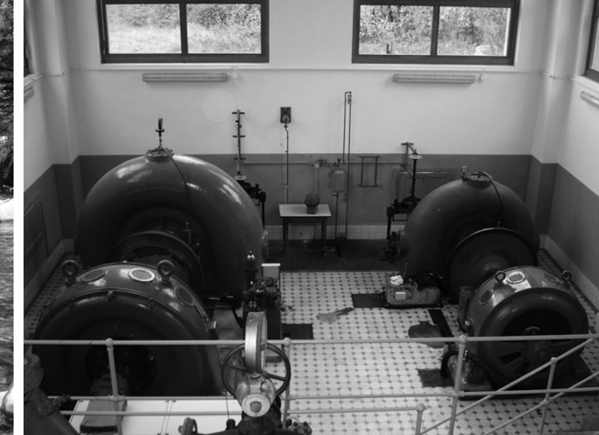
Les deux turbines Francis existantes ont été révisées en 2010 et entièrement automatisées. La production d'électricité prévue est de 2,2 millions de kilowattheures.
